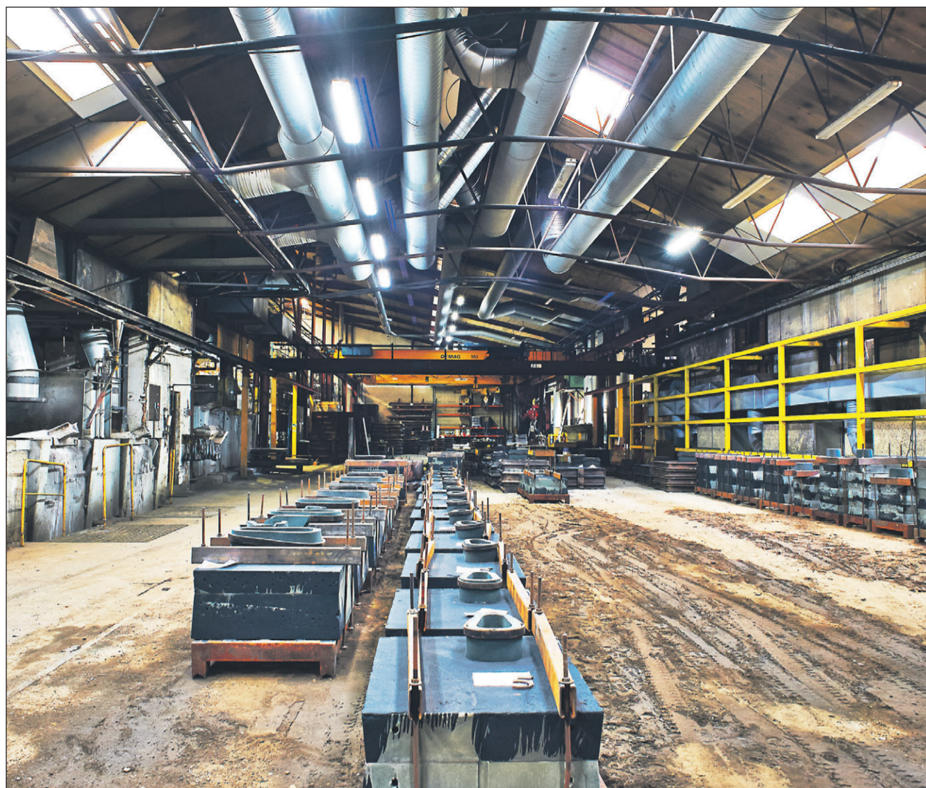
Uldalls Jernstøberi har investeret i mere effektiv ventilations- og filteranlæg, der også omfatter fortrængningsarmaturer i støberiet.
